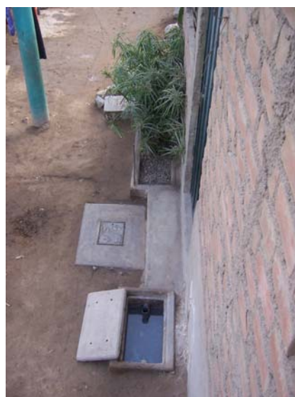
Fig. 21: Cámara atrapagrasas y humedal artificial, del subsistema domiciliario, Asociación de Vivienda Los Topacios, Nievería. Lima
